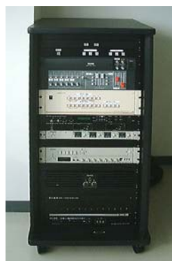
セミナー室 機器収納ラック
