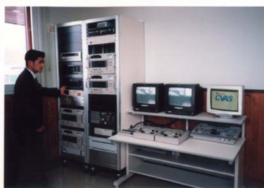
事務室内映像制御卓・ラック
