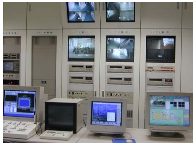
防災センター内ITV架
