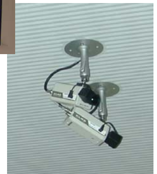
1階エントランスカメラ
