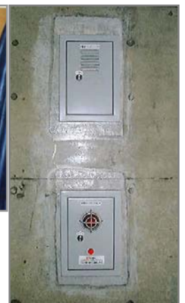
警報端子盤・操作器
