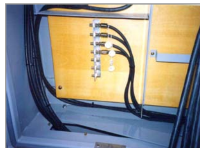
中継端子盤内部
