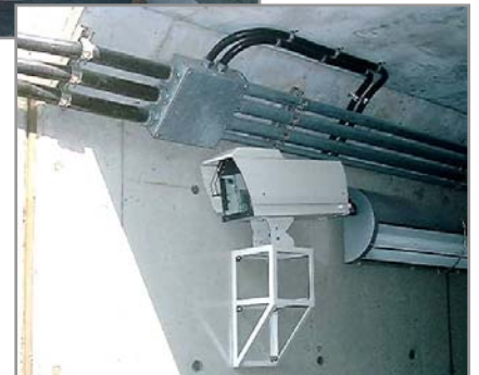
歩行者専用トンネル出入り口に設置された監視カメラ
