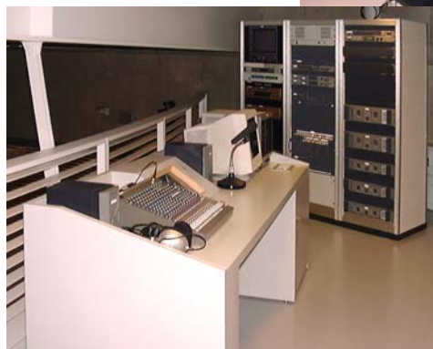
送出用ラック、AV操作卓 中会議室用移動ラック
