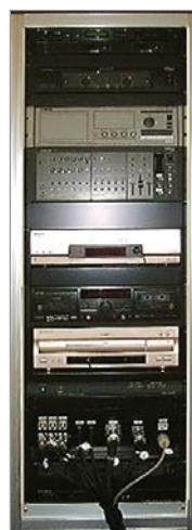
セミナー室 機器収納ラック
