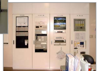
事務室に備えられた ITV架、防災複合盤
