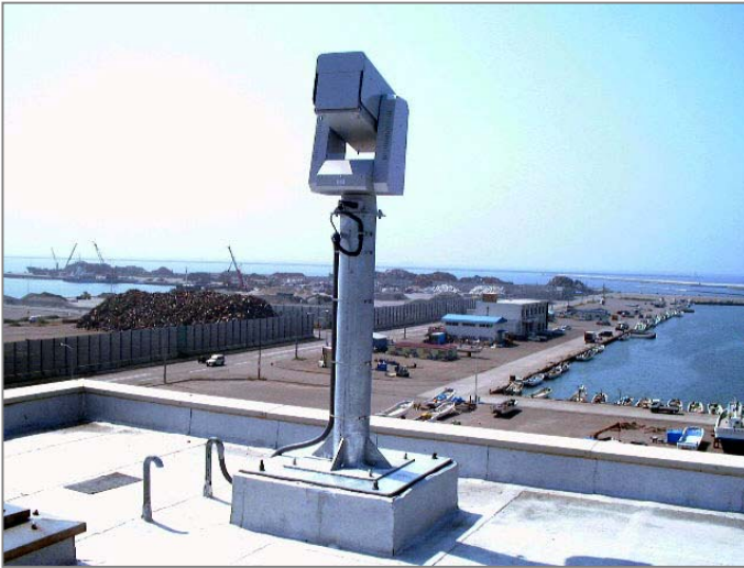
監視カメラ装置
