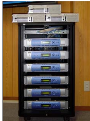
HDDレコーダーラック (支配人室)
