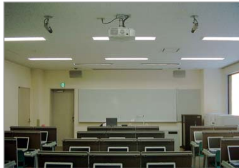
各室天井部に設置された液晶プロジェクター、板書撮影用カメラ
